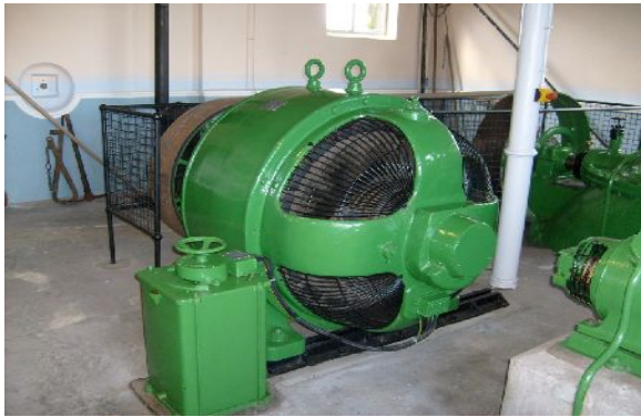
Interieur van het gemaal Eemnes
